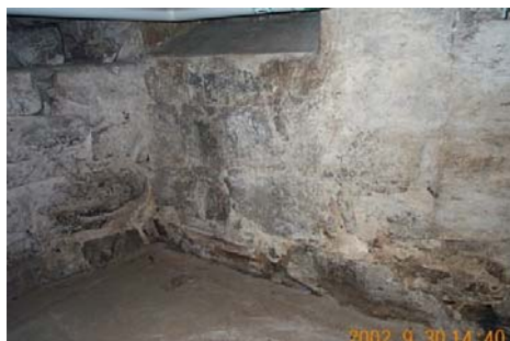
Äkta hussvamp i yttervägg
