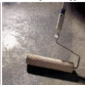
Mögel i betonggolvet
